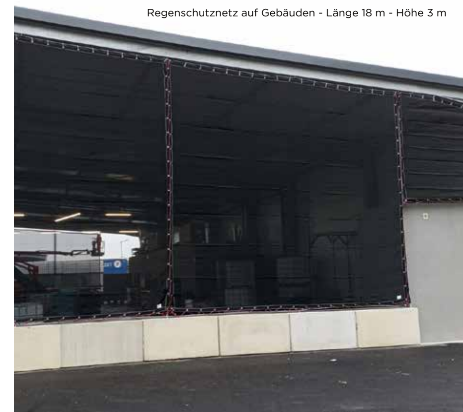
Regenschutznetz auf Gebäuden - Länge 18 m - Höhe 3 m
